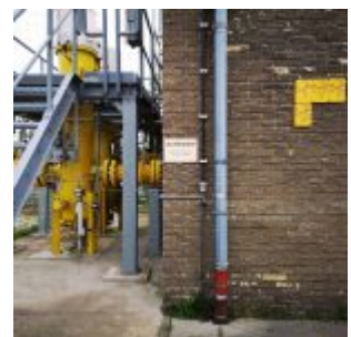
Pumpwerk im Hafen
