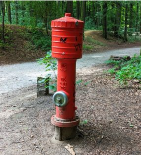
Hydrant im Wald
