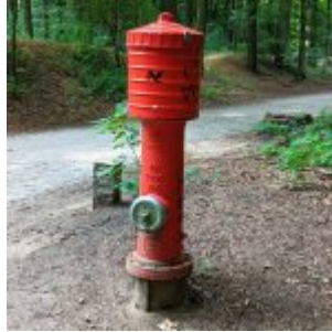
Hydrant im Wald
